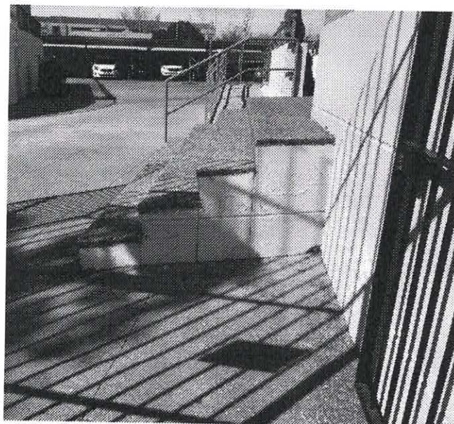
Primer plano de la escalera de entrada sin barandilla
