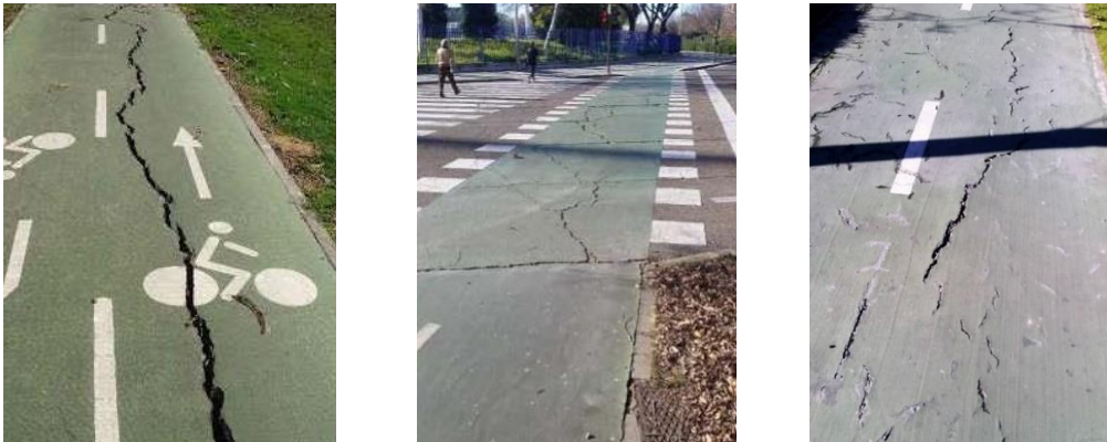
Figura 46. Deterioro de los carriles bici. Fuente: Patinadores de Sevilla
